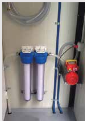
POMPA PER FILTRAZIONE ACQUE ▼
